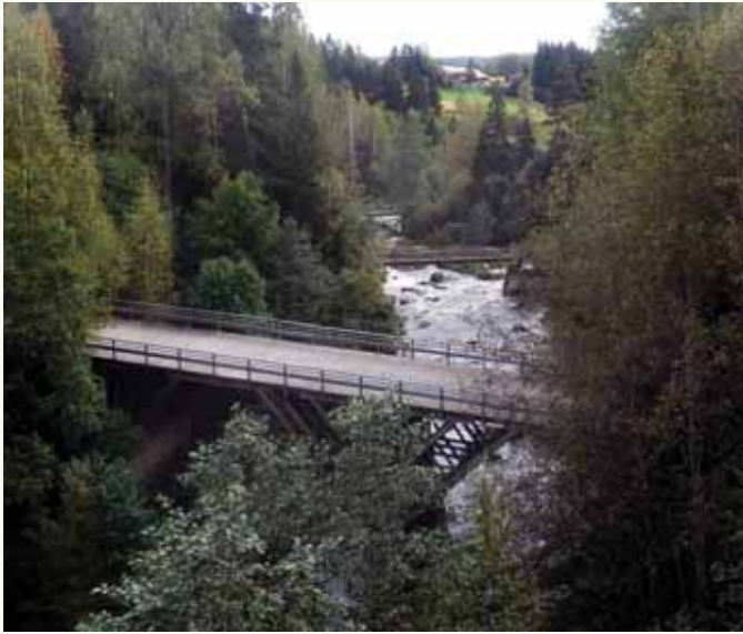
Kuva 14. Myllykoskessa on nyt neljä ylitystä. Aikanaan siinä on ollut myllyt molemmilla rannoilla sekä saha ja sähkölaitos, joiden rakenteita voi vieläkin nähdä.
